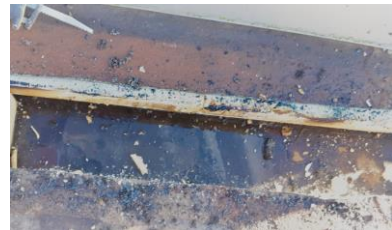
Wasser unter der Isolationsschicht
